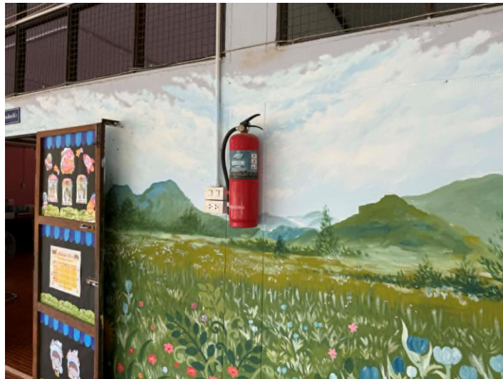
ถังดับเพลิง
