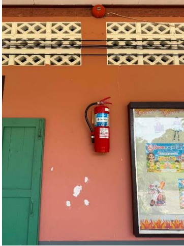
ถังดับเพลิงมีความติดตั้งในทุกอาคาร
