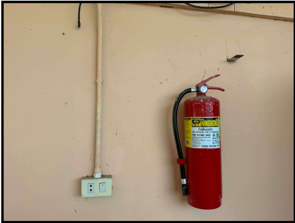
ภาพที่ ๑.๔ มีการจัดเตรียมอุปกรณ์ป้องกันและระงับอัคคีภัย
