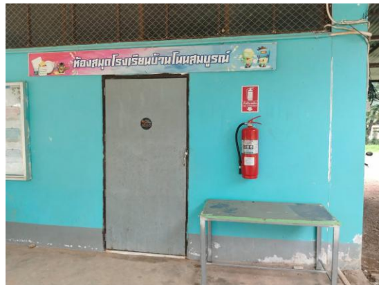
ภาพที่ 4 จัดเตรียมถังดับเพลิงในจุดที่เข้าถึงได้สะดวก
