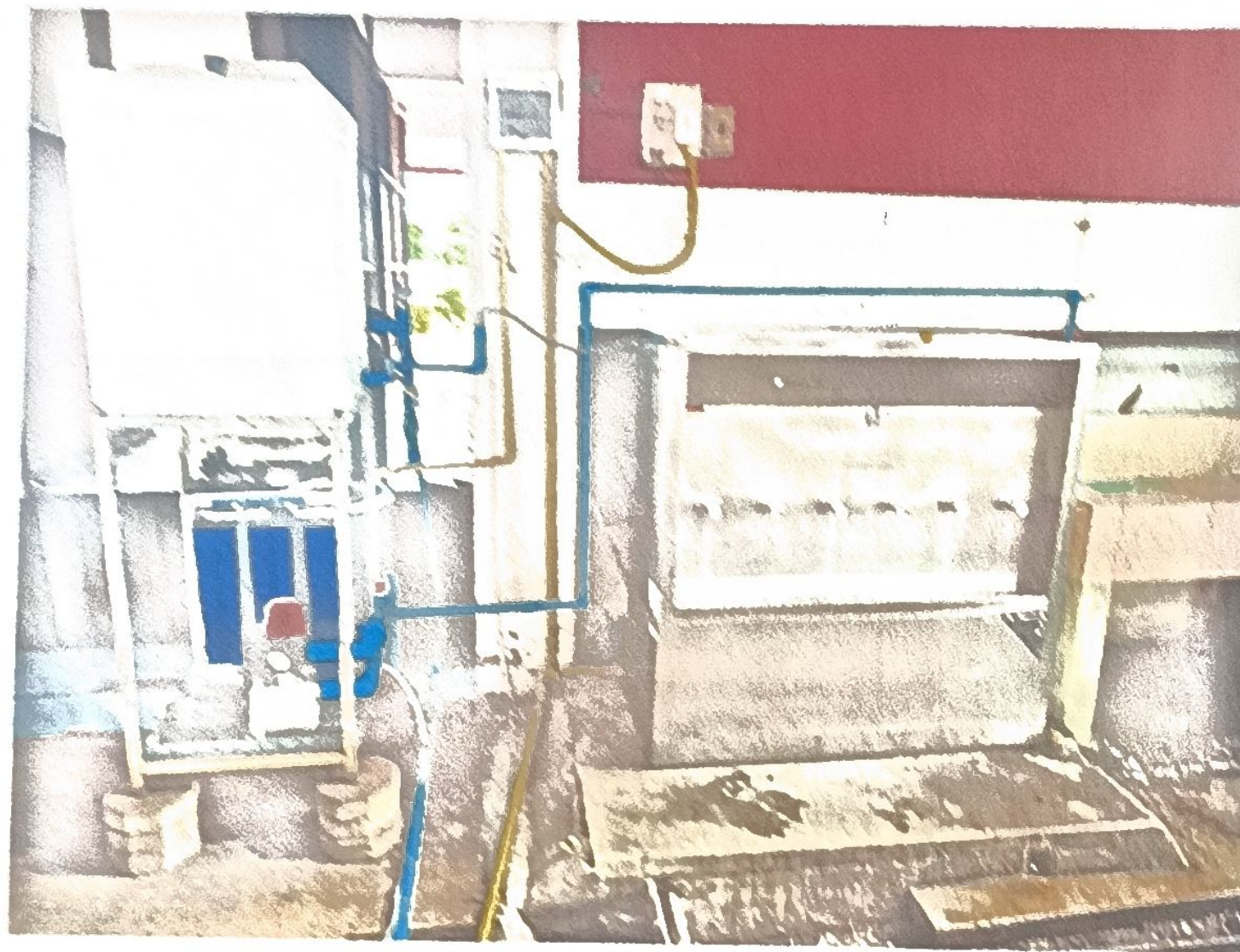
บริเวณถังน้ำดื่ม
