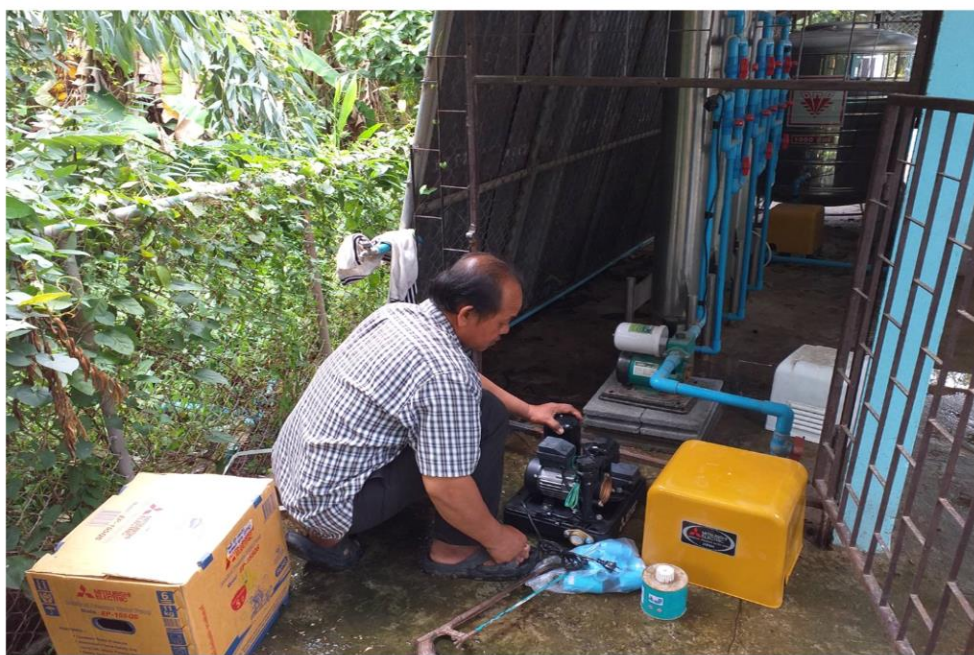
ดูแลตรวจสอบระบบเครื่องกรองน้ำดื่มเพื่อความปลอดภัยและพร้อมใช้งาน
