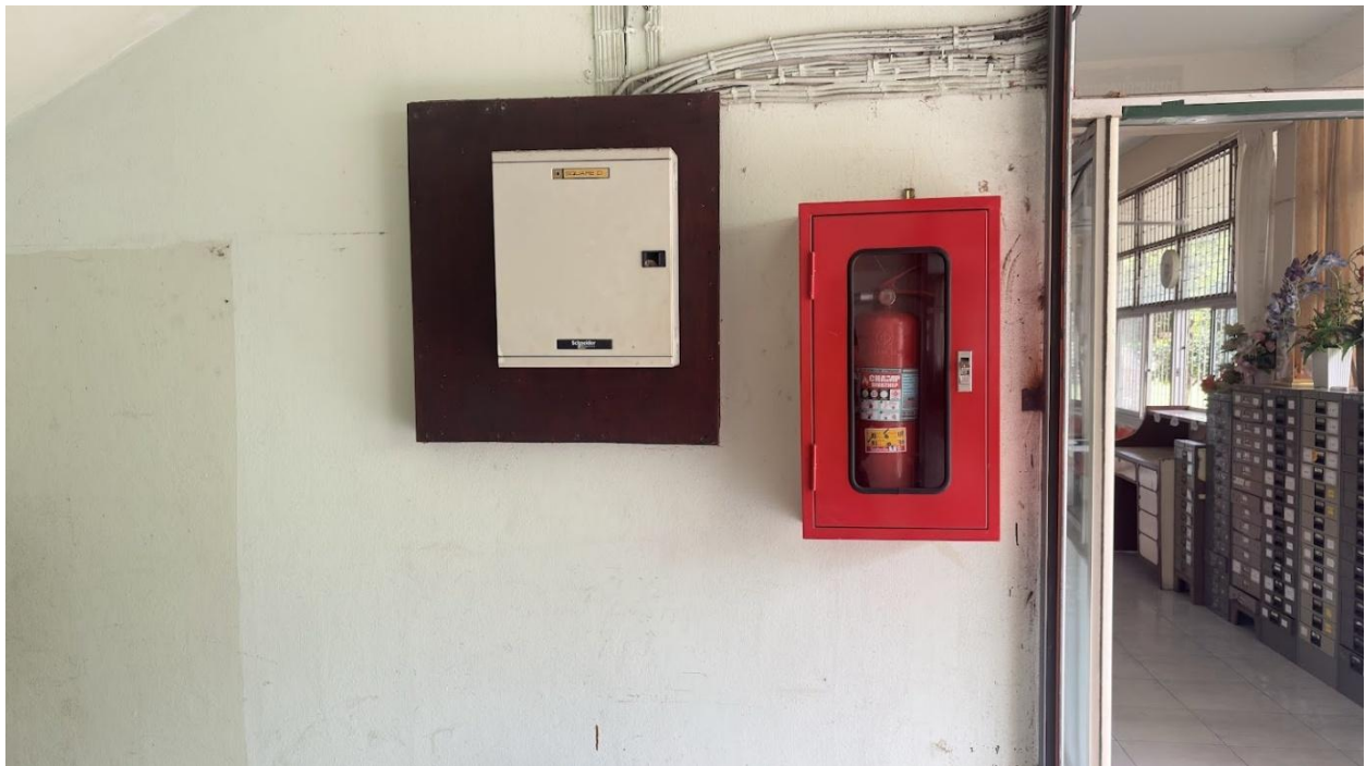
อุปกรณ์ป้องกันและระงับอัคคีภัยให้เพียงพอและพร้อมใช้งาน
